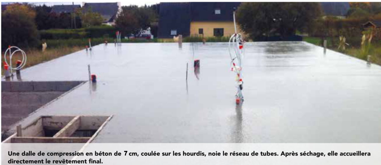
Pose des panneaux treillis soudés. Après raccordement au collecteur (deux au-delà de 100 m 2 ), une seule mise en pression permet de tester l'ensemble des circuits à l'air comprimé. Aucun raccord n'est réalisé dans la dalle.
